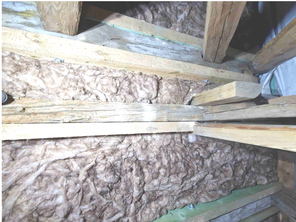
fot. 9. Widok śladów czynnego żerowania owadów w belkowaniu sklepienia kościoła – wzmocniony strop nad prezbiterium – grudzień 2023 r.
