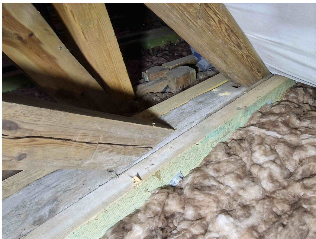
fot. 7. Widok śladów czynnego żerowania owadów w belkowaniu sklepienia kościoła – wzmocniony strop nad nawą w strefie sygnaturki – grudzień 2023 r.
