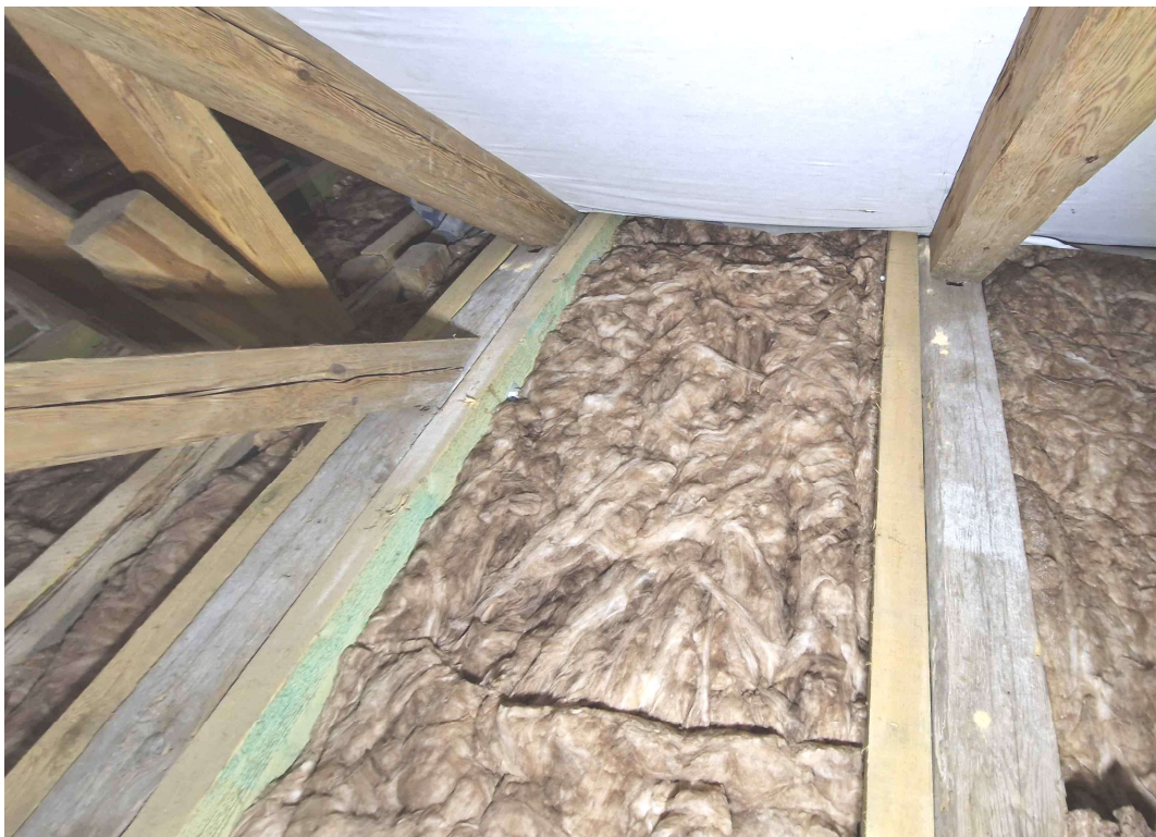
fot. 10. Widok śladów czynnego żerowania owadów w belkowaniu sklepienia kościoła – wzmocniony strop nad prezbiterium – grudzień 2023 r.
