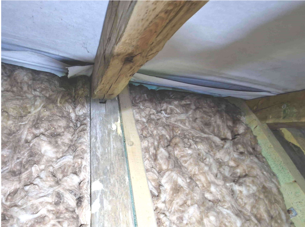
fot. 8. Widok śladów czynnego żerowania owadów w belkowaniu sklepienia kościoła – wzmocniony strop nad prezbiterium – grudzień 2023 r.
