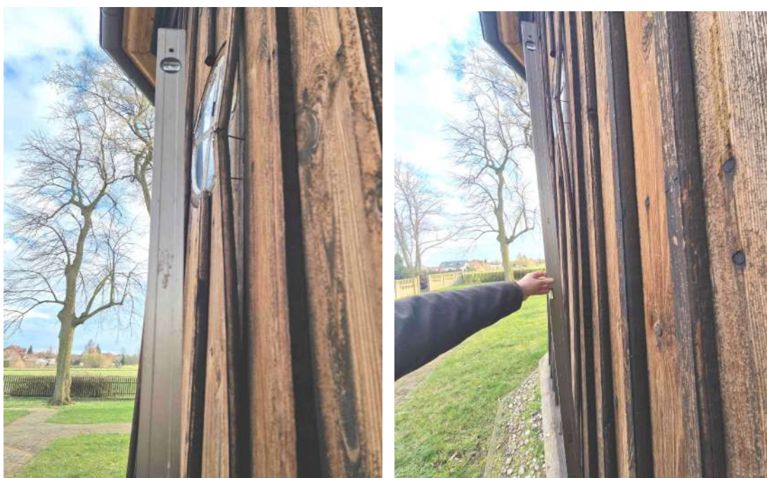
fot. 21. Widok pomiaru odchylenia górnej części ścian trójbocznego zamknięcia prezbiterium
