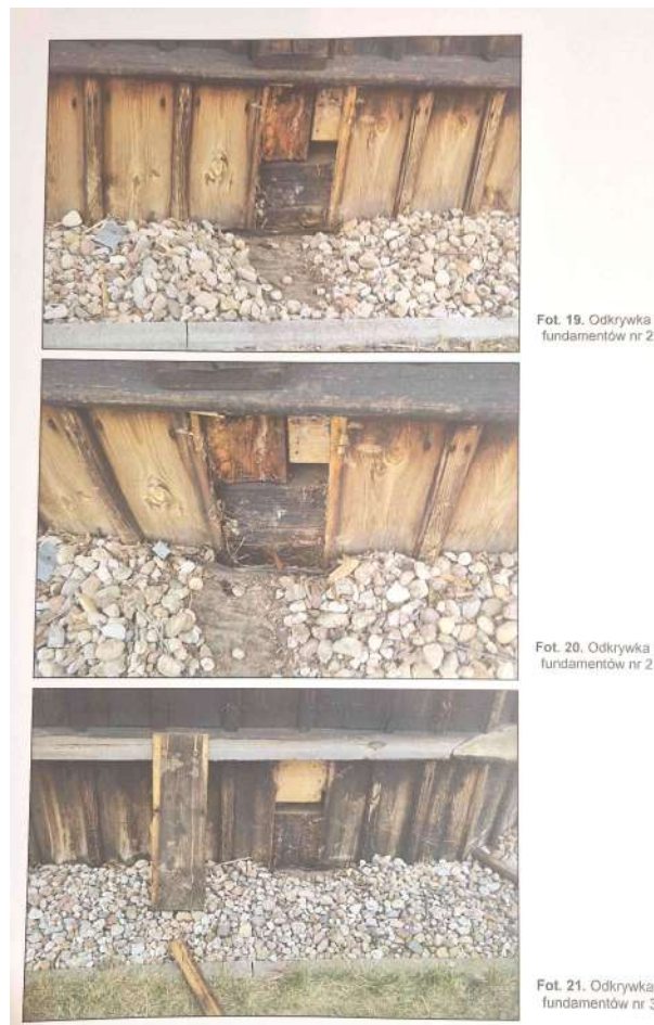
fot. 10. Fotografie odkrywki nr 2 i 3 fundamentów z opracowania [2] Ekspertyza techniczna..
