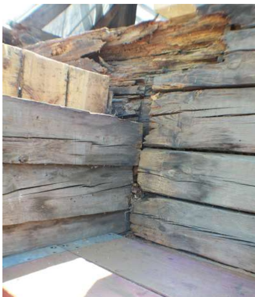
fot. 15. Widok uszkodzeń drewnianych ścian w obrębie zakrystii i prezbiterium w trakcie remontu w 2016 r.
