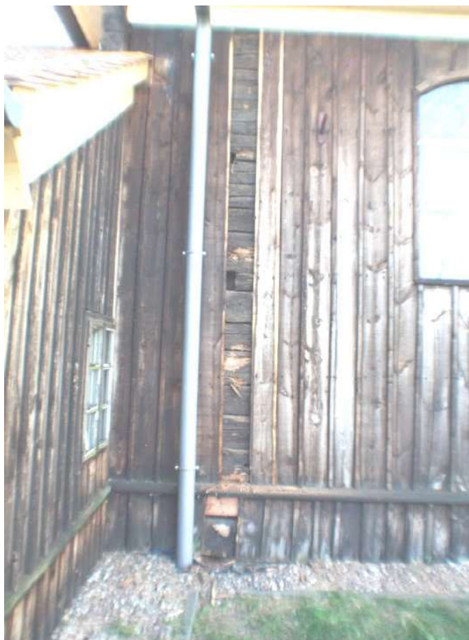
fot. 19. Widok uszkodzeń odkrytej konstrukcji ściany nawy – strona północna
