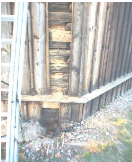
fot. 18. Widok uszkodzeń odkrytej ściany zrębowej prezbiterium – strona południowa
