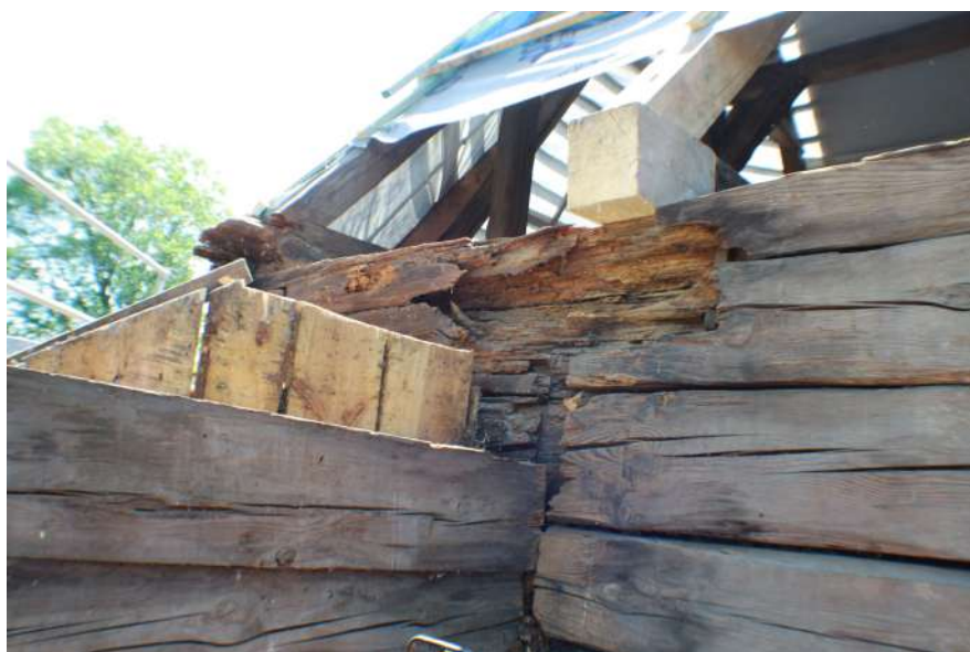
fot. 14. Widok uszkodzeń drewnianych ścian w obrębie zakrystii i prezbiterium w trakcie remontu w 2016 r.
