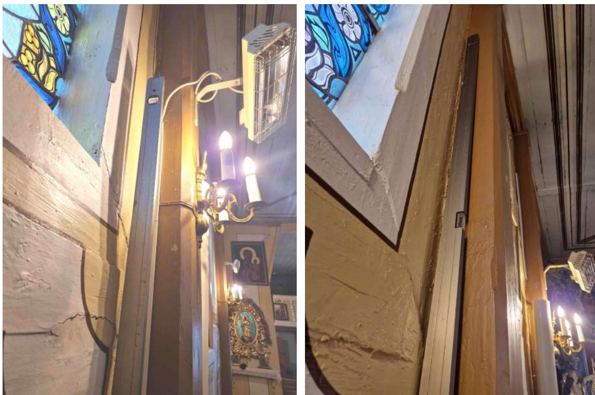
fot. 22. Widok pomiaru odchylenia górnej części ścian pierwotnej nawy
