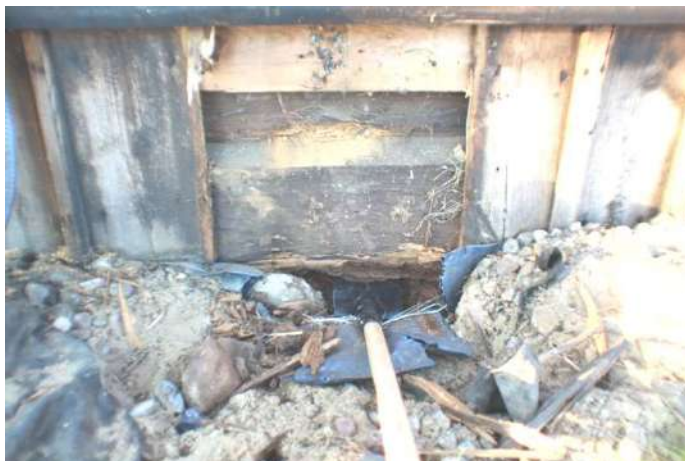
fot. 17. Widok uszkodzeń drewnianych ścian w obszarze odkrywki fundamentu w strefie nawy – strona południowa
