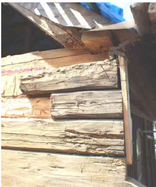
fot. 16. Widok uszkodzeń ścian nawy na styku z prezbiterium – remont w 2016 r.
