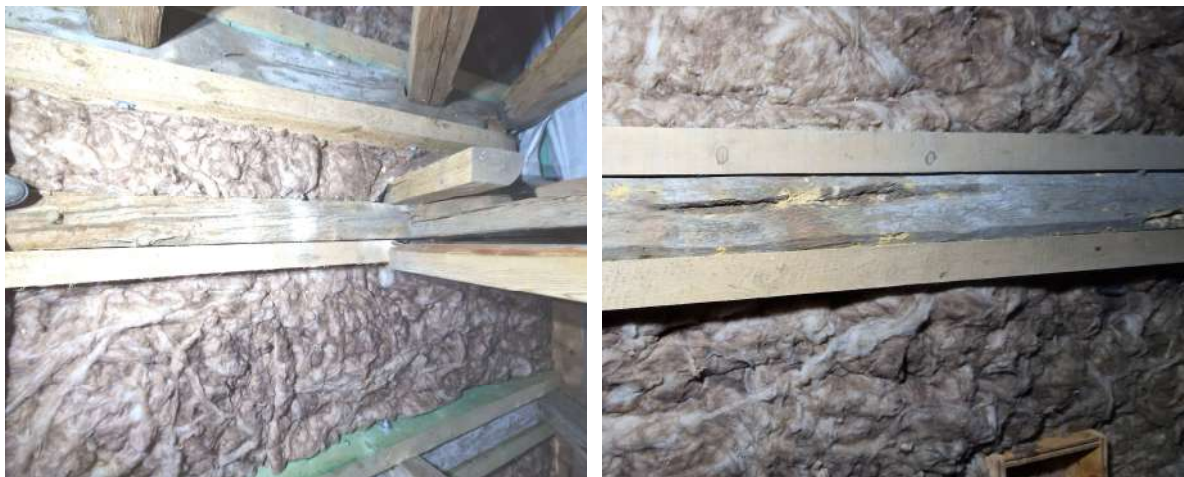
fol. 24. Widok czynnego żerowania owadów na belkach stropu
